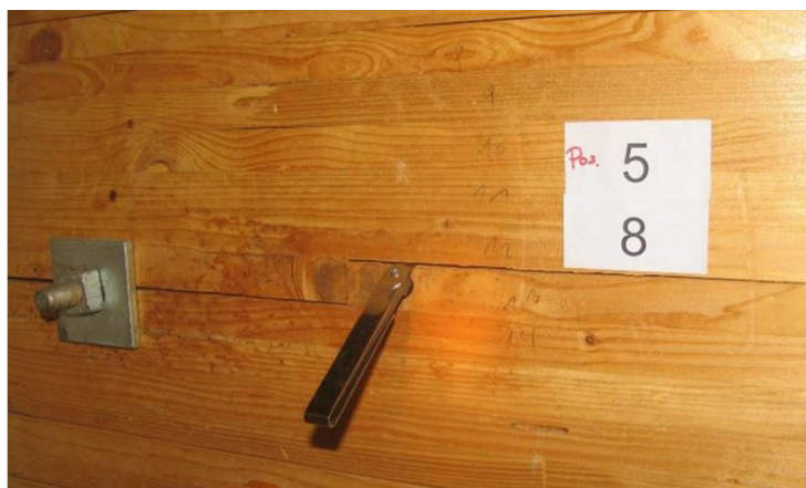
Abb. 1: Delaminierung im Brettschichtholzträger mit typisch geradlinigem Verlauf
