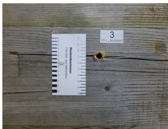
Abb. 2: Kennzeichnung einer Probenentnahmestelle mit Zuwachsbohrer und Rissbreitenmessung
