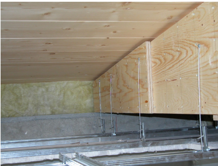
Abb. 6: Satteldachträger mit aufgeklebten Furnierschichtholz-Schubverstärkungen
