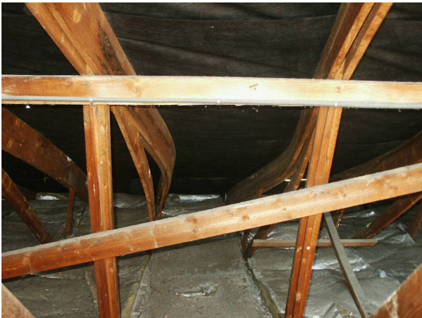
Abb. 20: Ausknicken von druckbeanspruchten Obergurten an Brettbindern
