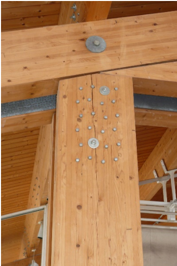
Abb. 18: Anschluss im Innenbereich mit typischer Rissentwicklung, Quelle: Dr. Schütz Ingenieure (2011)
