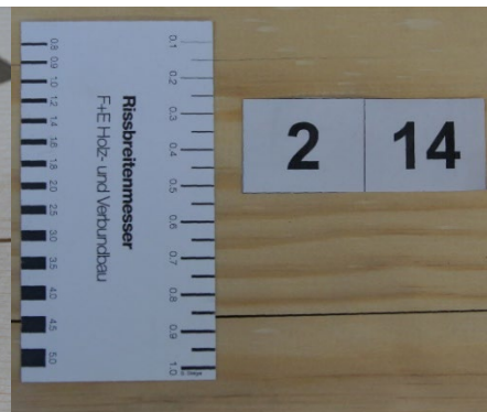
Abb. 23: Rissbreitenmessung an Pos. 2/14
