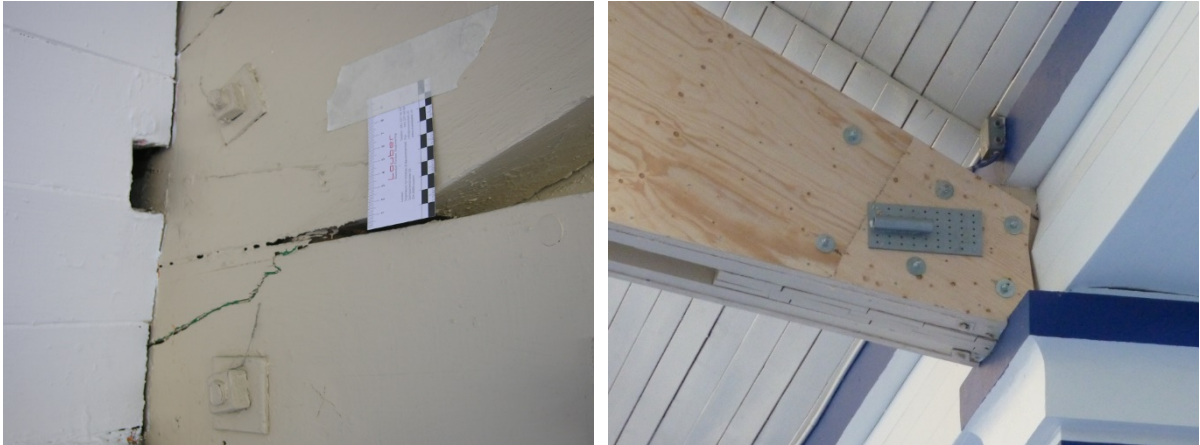
Abb. 3: Schubbruch beim Auflager, Knotenplatte zur Einleitung der Kräfte
