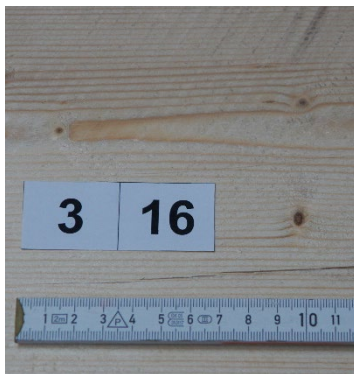
Abb. 21: Risslängenmessung an der Pos. 3/16
