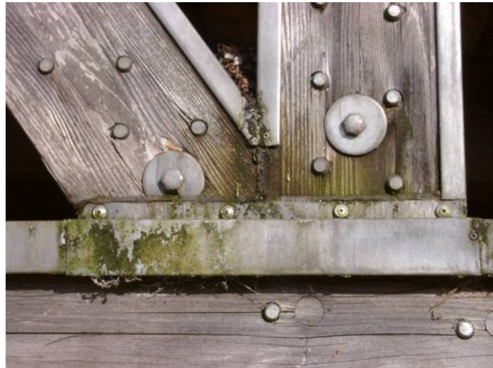
Abb. 19: Anschluss im Aussenbereich mit signalisierenden Verfärbungen und Rissen im Bereich der Stabdübel im Untergurt
