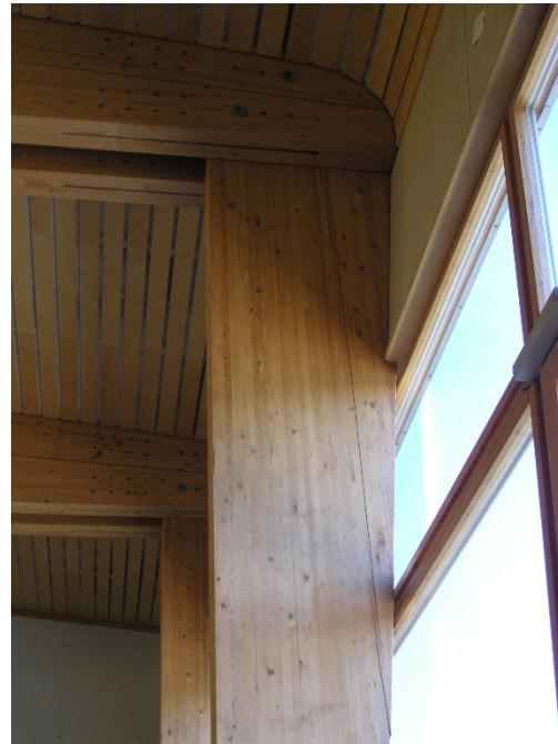
Abb. 5: Stütze mit durchgehendem Riss
