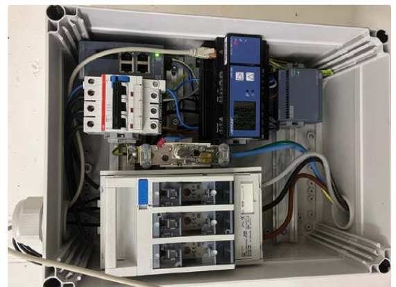
Ansatz 2: Intelligenter Hausanschlusskasten mit integrierter Mess- und Kommunikationstechnik
