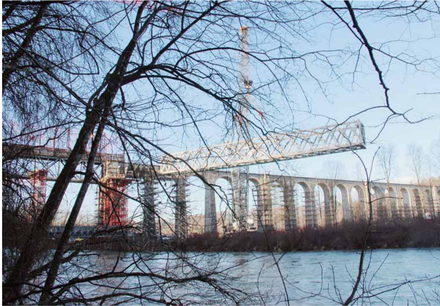
Das Saaneviadukt bei Gümmenen wird durch die BLS saniert und ausgebaut. ZVG/BLS
