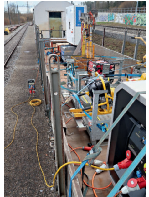
Nachladen der auf einem Flachwagen aufgebauten Energieversorgungssysteme (Foto: SBB).
