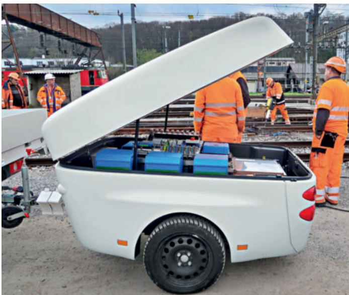
Strassengängiger Batterie-Anhänger für die Baustellenversorgung (Foto: SBB).
