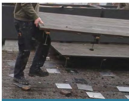
Heikel! Terrassenrost auf einem Flachdach
